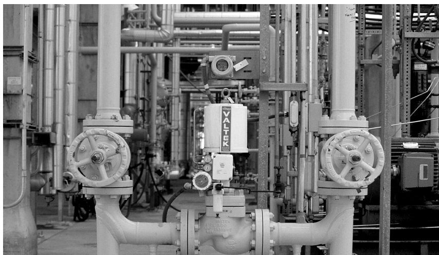
Клапан 8" для регулирования противодействия на установке по переработке жидких углеводородов. Давление на входе в клапан 580 фунт/кв.дюйм / 40 бар
