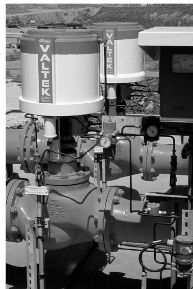
(Справа) Установка для отгрузки жидкого азота (Австралия) имеет два клапана Mark One в системе аварийного противопожарного водопровода
