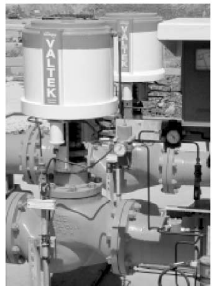
(Rechts) Eine Verladeanlage für Flüssigstickstoff in Australien mit zwei Mark One-Ventilen für das Löschwasser-system.
