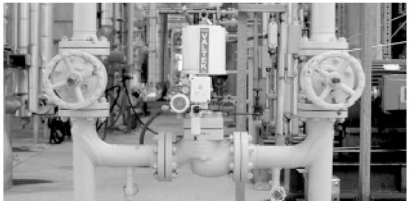
8-Zoll-Rückstaudruckventils in einem Werk für flüssigen Kohlenwasserstoff mit 580 psi/40 bar Vordruck.
