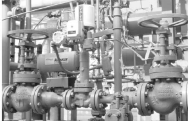
2-Zoll-Guardian II-Ventil in einem Chemiewerk.
