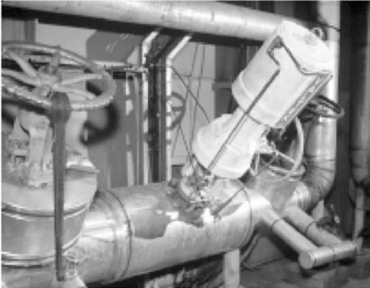
4-Zoll-Mark One-Ventil mit seitlich angebautes Handrad im Kesselspeisewasser-System einer Zellstofffabrik.
